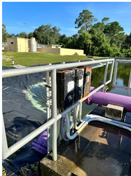
Effluent Reuse Pump Station
