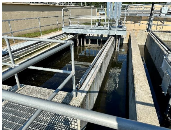
Effluent Reuse Filter 1
