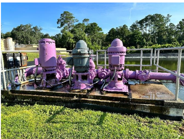
Effluent Reuse Pump Station
